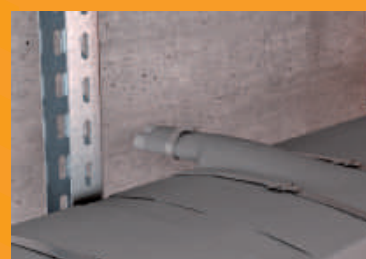
Кабельный вывод с бандажированием.
