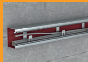
Фиксирующие скобы внутри канала для предотвращения выпадения кабеля
